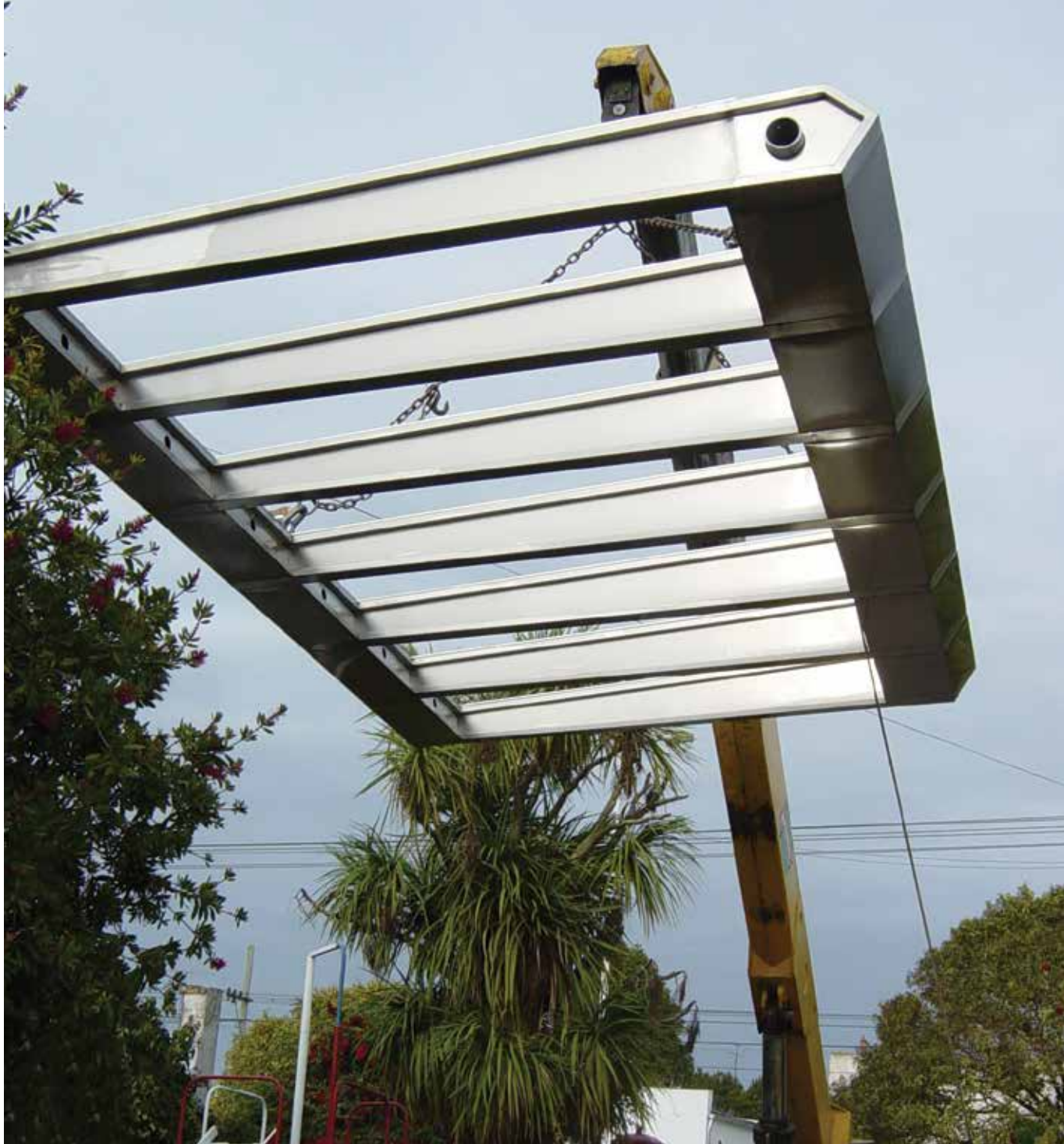
La estructura de la marquesina en Acero inoxidable en su izamiento a su posición final.
