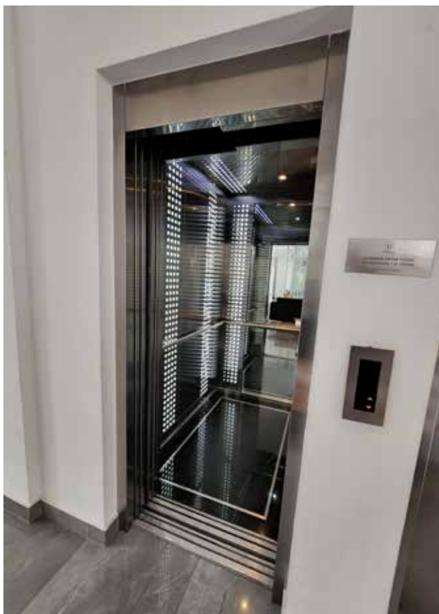
Uno de los cuatro ascensores, aplicando la iluminación como elemento decorativo de la cabina.
