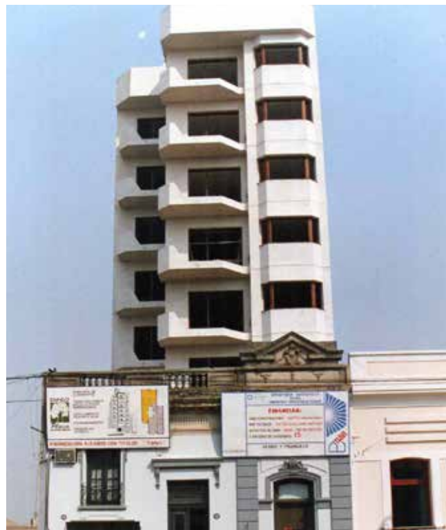
Edificio en proceso de obra con la cartelería del apoyo financiero a través de la operatoria TIAVI del BHN.
