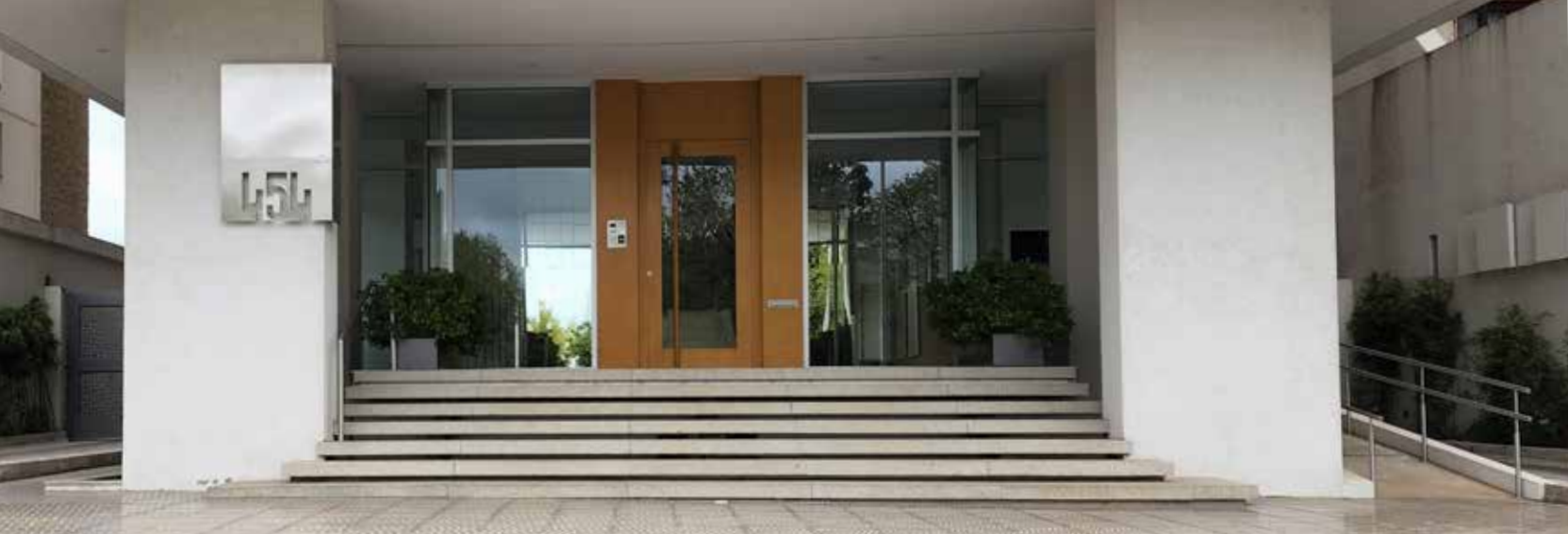
La escalera como actor protagonista para destacar el acceso al Edificio diseñada esta vez, con escalones flotantes de granito gris con la novedad de transparencias a un espejo de agua.
